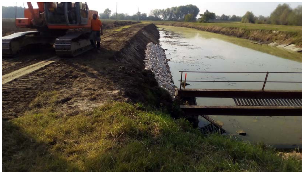
Ripresa frana nel canale Cavamento in prossimità dell’impianto Roncole di Gazzuolo
