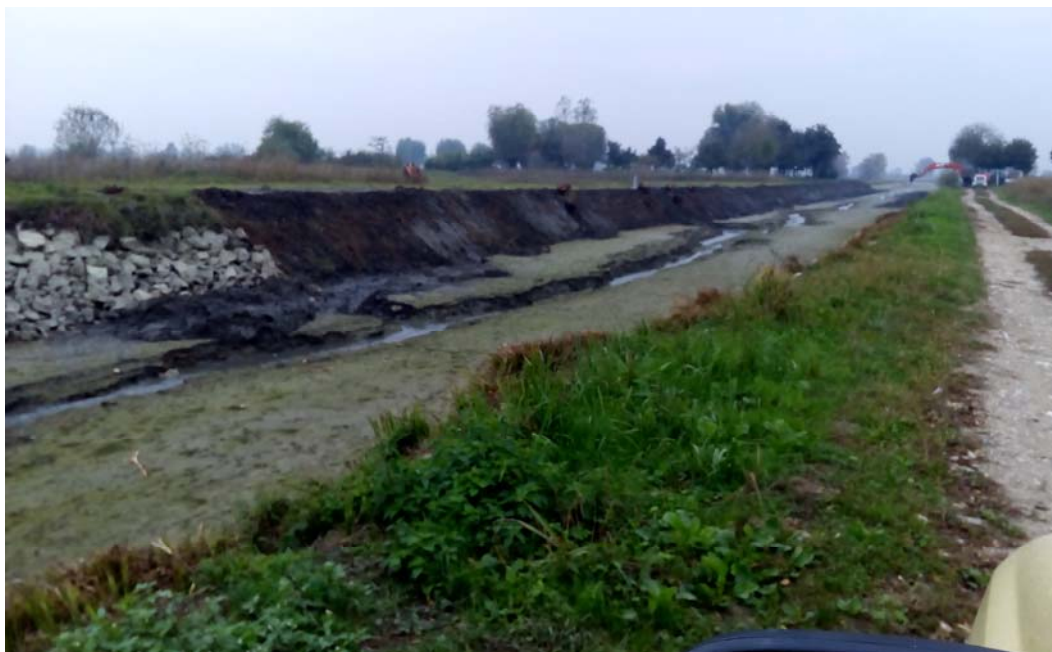
Ripresa frana nel canale Diversivo Casalasco in prossimità del sostegno Quattro Luci
